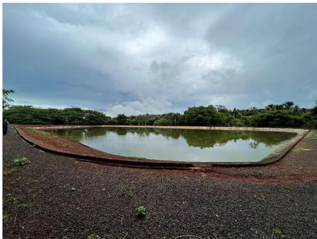
Figura 44: Sistema Sede – Esgoto –Lagoa de decantação
