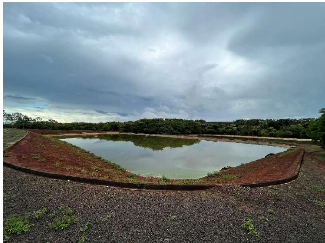
Figura 47: Sistema Sede – Esgoto – Lagoa facultativa Fonte: Visita ao município
