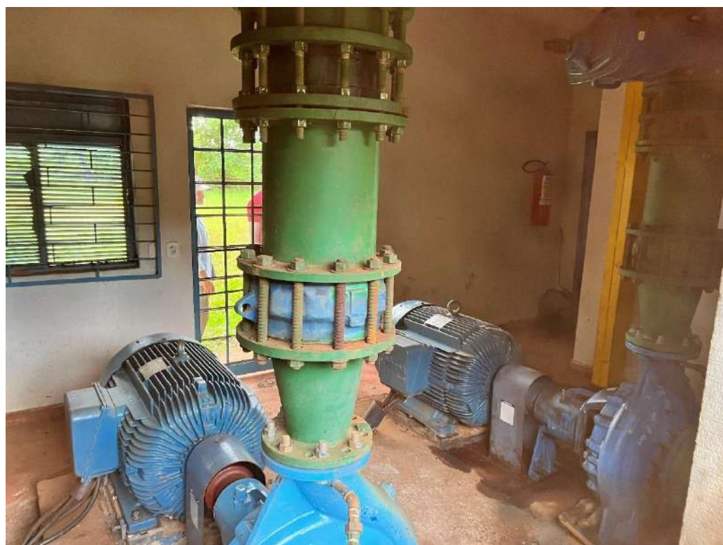
Figura 30: Sistema Sede – Água – EEAB. Fonte: Visita ao município.
