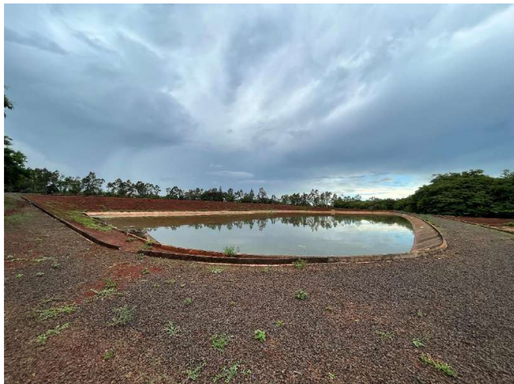
Figura 51: Sistema Sede – Esgoto – Lagoa facultativa Fonte: Visita ao município
