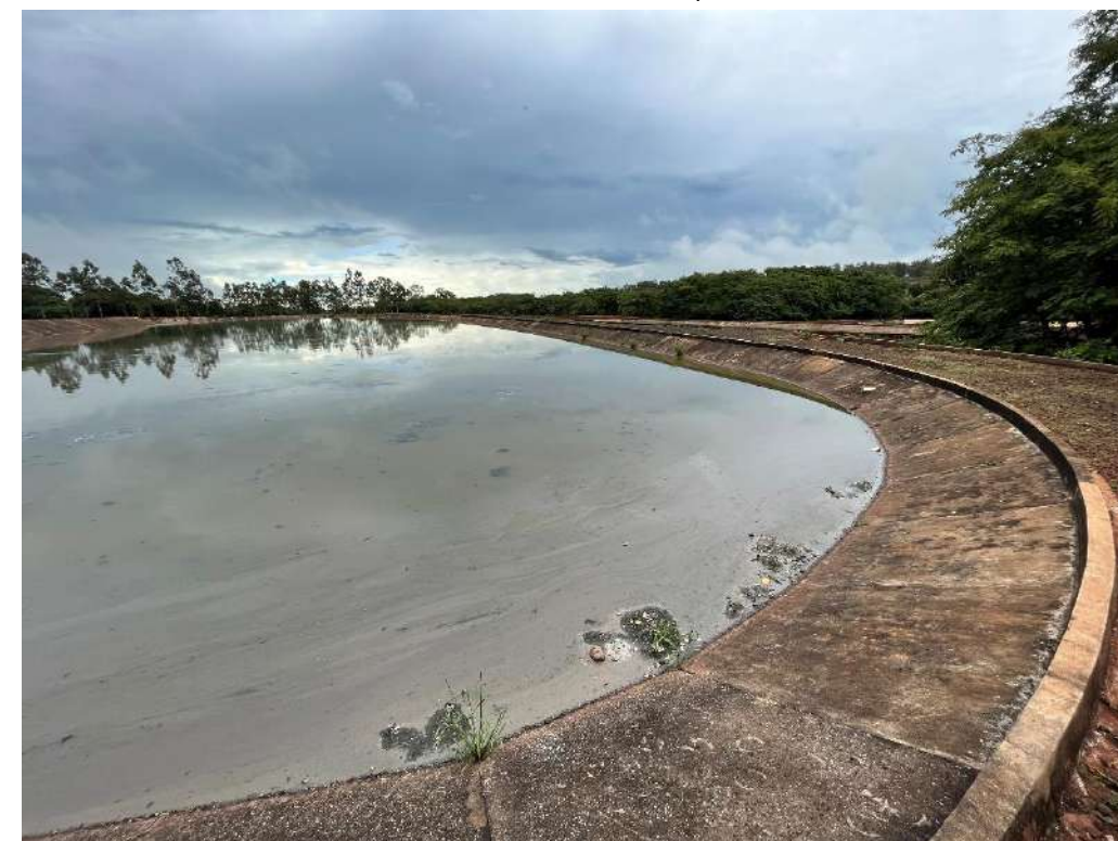
Figura 46: Sistema Sede – Esgoto – Lagoa facultativa
