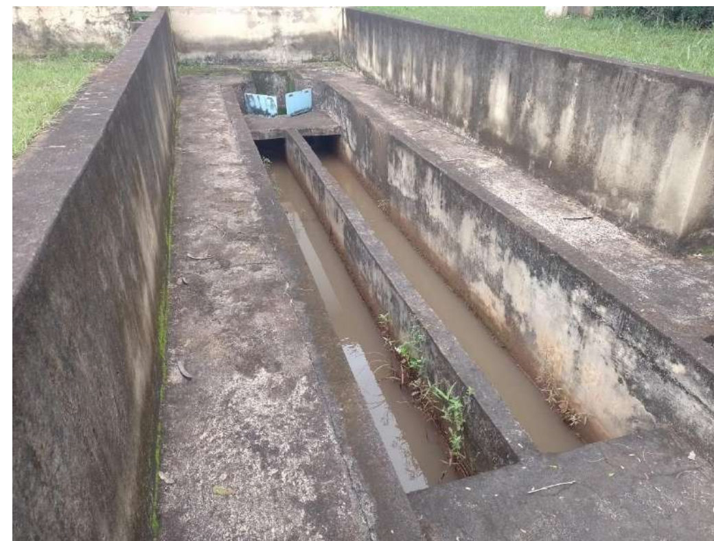
Figura 24: Sistema Sede – Água – Caixa de areia na captação - sede. Fonte: Visita ao município.
