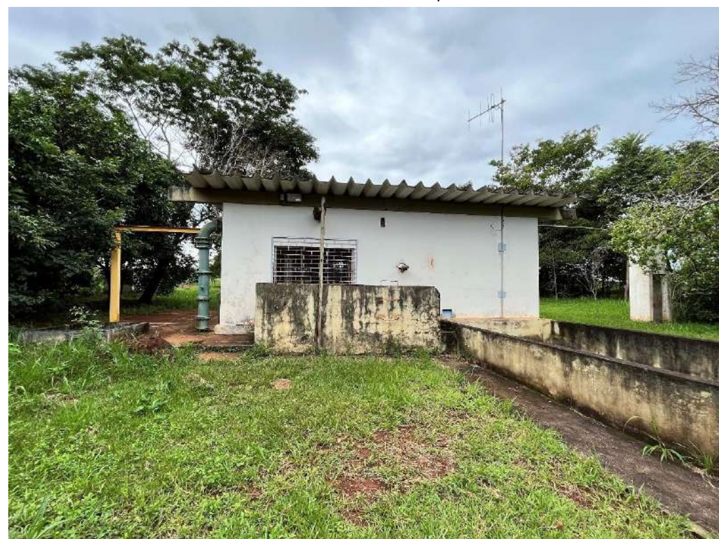
Figura 27: Sistema Sede – Água – Caixa de areia na captação - sede.
